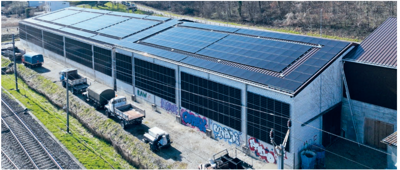
Die mit 552 kWp grösste Photovoltaikanlage der EKT AG im Berichtsjahr.
